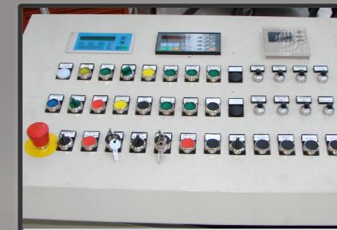
Pannello di controllo
